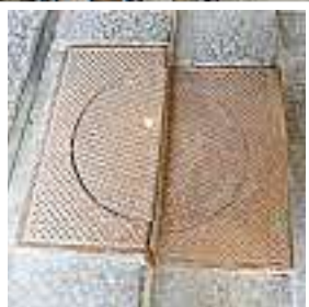
Versetzter Schachtdeckel auf der Schloss-treppe in Thun BE . Das Muster, das an Schoggitäfeli erinnert, soll die Rutschgefahr bei Nässe minimieren.
